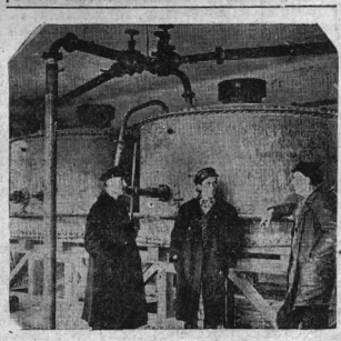
Инженер конструктор тов. Штангаев осматривает установленный конструктор его системы на новос Угловском лесопильном заводе
