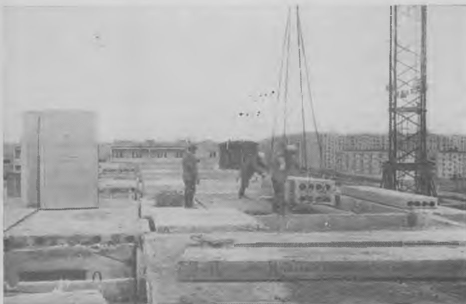
Рис. 1. Строительство жилых зданий серии 125 в Череповце с ограждающими и несущими конструкциями из шлакопемзобетона
