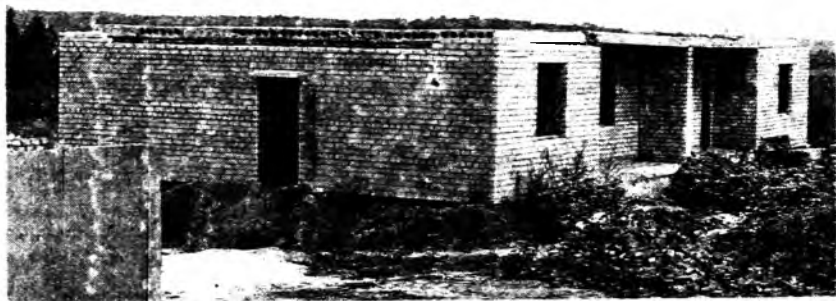
Рис. 3. Стены строящегося дома из мелких пенозолобетонных блоков, облицованных кирпичом (пос. «Березка» Курской обл.)
