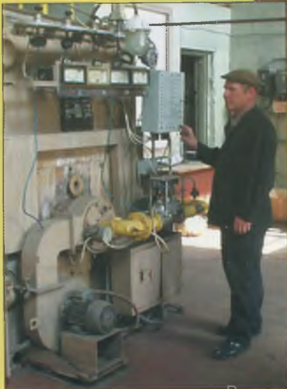
Котельная на газовом топливе
