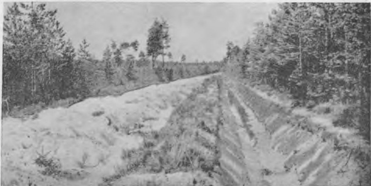
Рис. 5. Начало строительства дороги. Грунт, вынутый из кювета, укладывается на полотно с отступлением от бровки кювета на 0,5—0,75 м.
