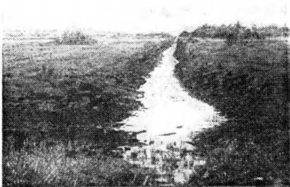
Разрушение откосов канала скотом
