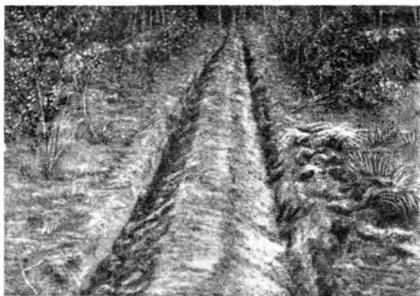
Полоса после расчистки корчевателем Д-210 и обработки плугом СПН-140. Кузьминское лесничество (Московская область)
