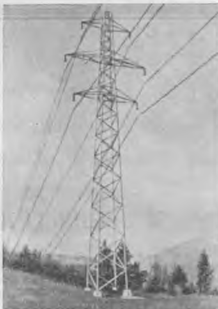
Рис. 2. Специальная промежуточная опора высотой 67 м.
