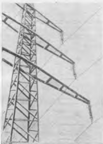
Рис. 1. Стержневые изоляторы СП-110 на опоре.
